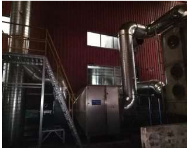
废气处理系统-2
