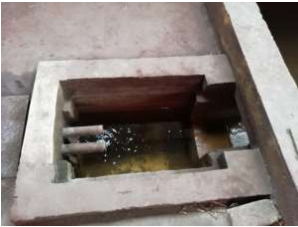
中水回用出水口
