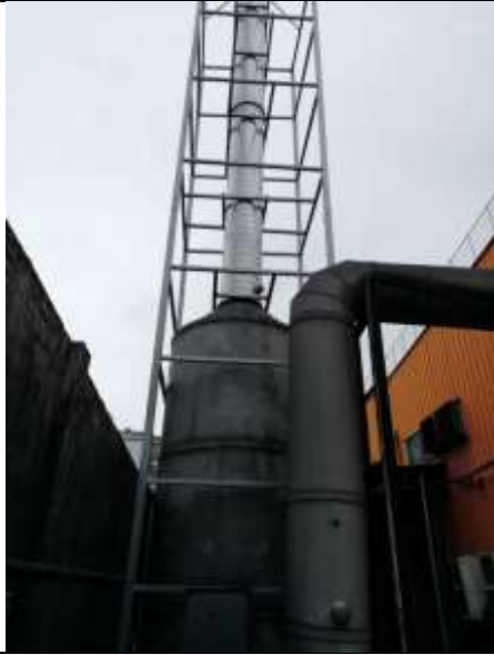
废气处理系统-1
