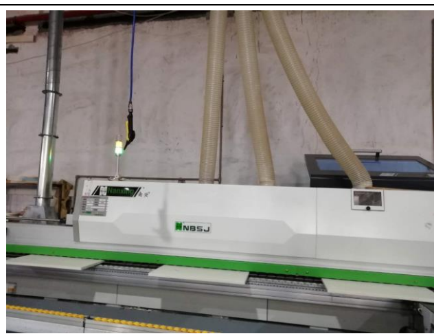
废气收集系统-2
