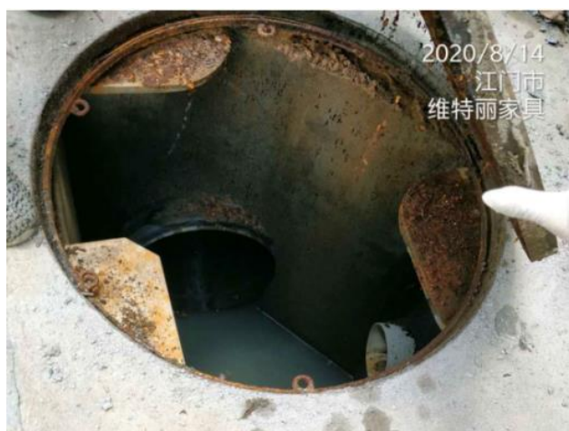
生活污水排放口
