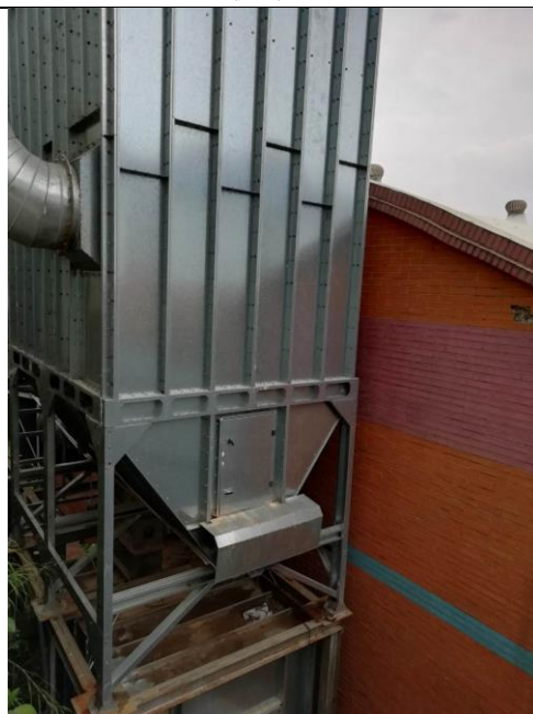
废气处理设施
