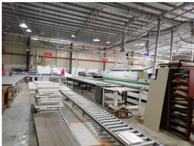
废气收集管道
