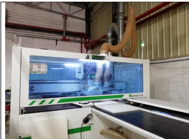
废气收集系统-1
