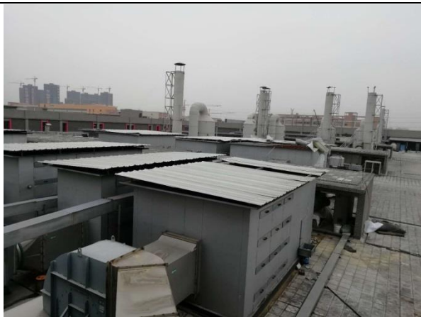
废气处理系统-1
