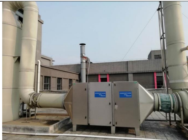
废气处理系统-2
