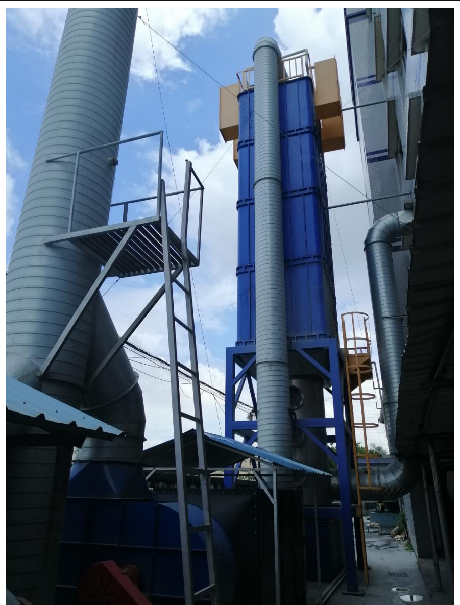
废气处理设施-2
