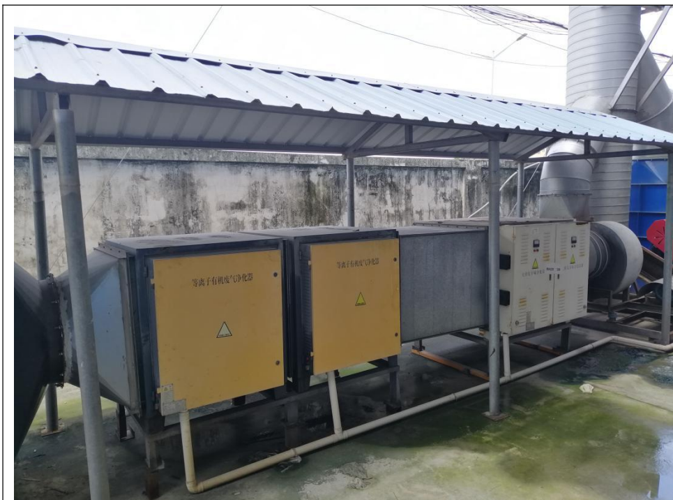
废气处理设施-1
