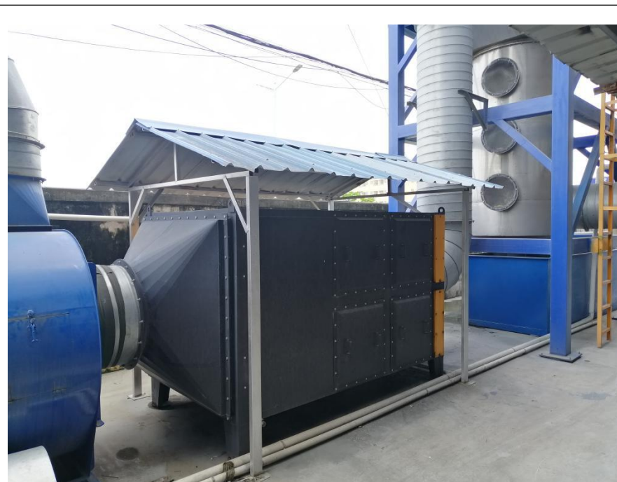
废气处理设施-2
