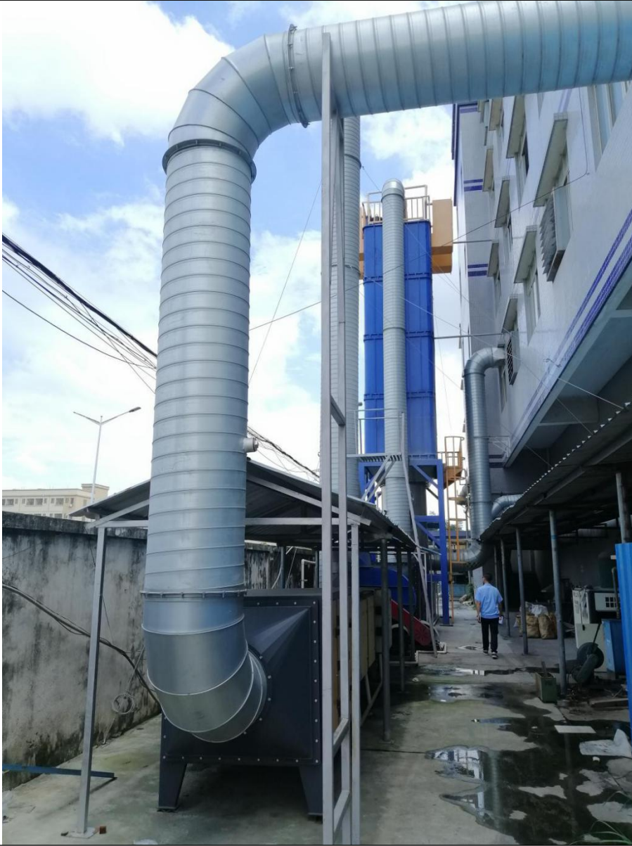
废气处理设施-1
