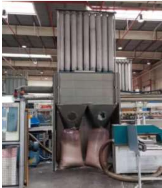
生产设备自带的粉尘收集系统
